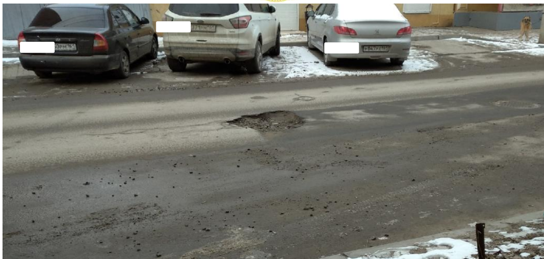
Рис. 2. Неровность дорожного покрытия на отрезке улицы Социалистической между переулками Крепостной и Журавлева (Ростов-на-Дону)
