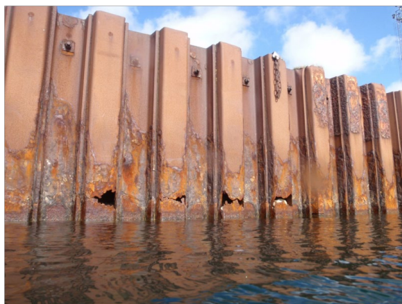
Рис. 1. Разрушение шпунтового ограждения под воздействием коррозии в водной среде [10]
