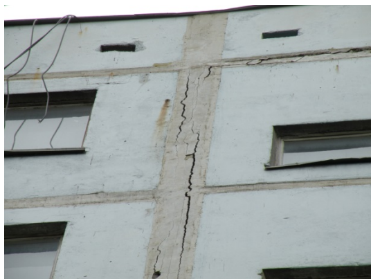
Рис. 1. Трещины в стыках, подвижка по швам стеновых панелей
